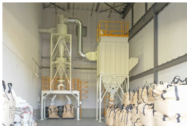
写真3 サイクロンおよび集塵機
