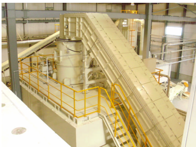
写真1 NO. 2コンベヤおよびストックバンカー
